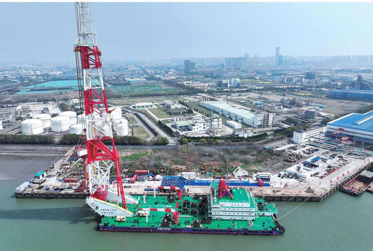
3月31日在江苏南通拍摄的156米动力定位打桩船“铁建大桥桩1”号（无人照照片）。
