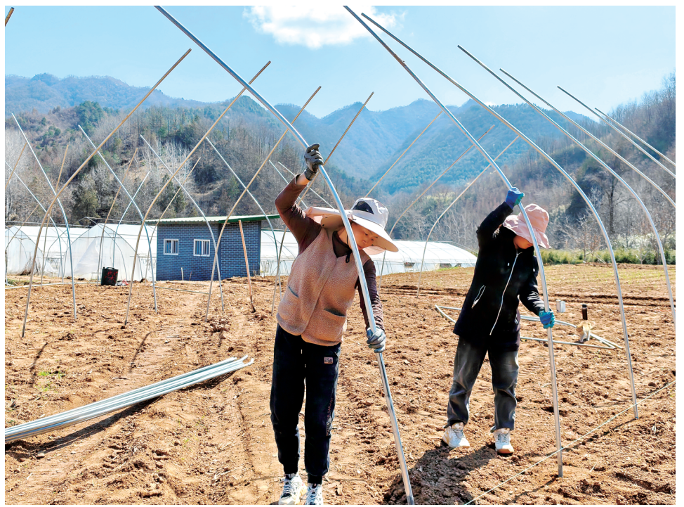
眼下正值春耕备耕的黄金时节，在徽县榆树乡王庄村，菌瓜轮作种植二期基地钢架大棚搭建工作正在紧锣密鼓推进。 本报通讯员 燕宏瑞 摄
