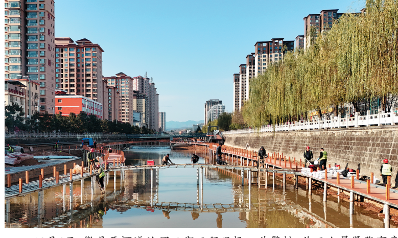
12月6日,徽县西河河道治理二期工程现场一片繁忙,施工人员在紧张有序作业。工程将重塑西河河道水韵生态,让河水清澈,堤岸翠绿。 本报通讯员 燕宏瑞 摄
