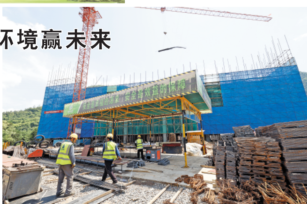
甘肃瑞能矿业有限公司年处理150万吨铅锌矿选矿厂项目正在加快建设。
