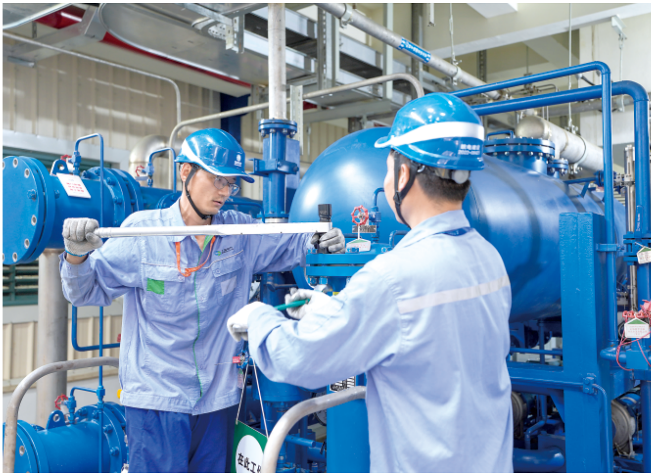
5月25日，国网安徽电力检修人员对古泉换流站调相机设备进行检修、维护。近日，昌吉-古泉±1100千伏特高压直流输电线路的受端站——安徽宣城古泉换流站调相机设备迎来为期20天的“体检”。调相机被誉为电网的“稳压器”，此次开展各类检修、试验、消缺项目可有效解决新能源大规模接入电网带来的电压稳定问题，提升输电安全可靠，为长三角地区经济发展提供有力能源支撑。昌吉-古泉±1100千伏特高压直流输电工程起于新疆昌吉换流站，止于安徽古泉换流站，是目前世界上电压等级最高、输送距离最远、输送容量最大的输电工程。 新华社记者 刘军喜 摄
