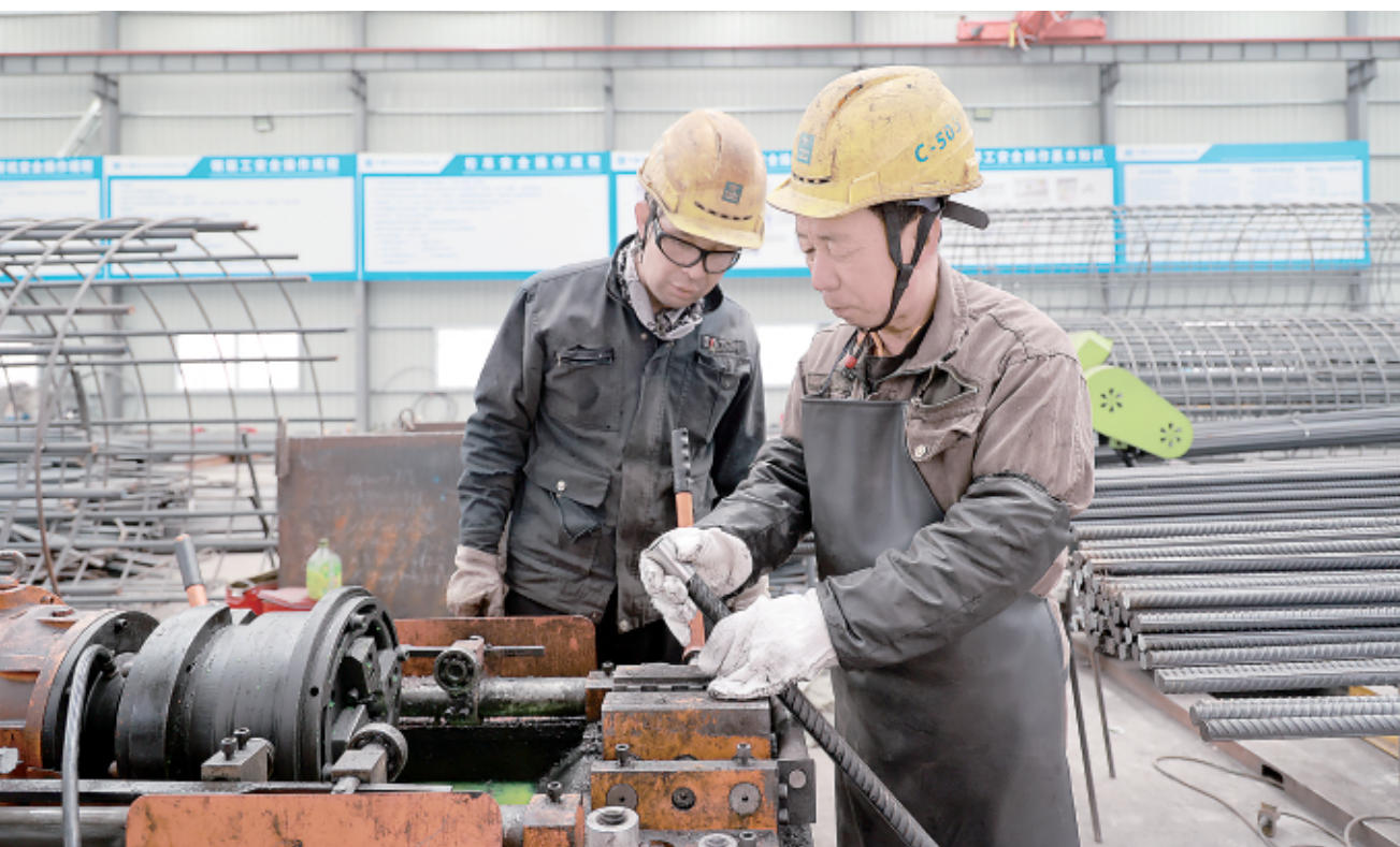
人勤春来早，建设正当时。3月9日，在成县中建铁投集团天院项目钢筋加工车间，工人正在进行钢筋加工作业，为施工现场快速实现达标达产提供物料供应，同时，项目各工点已吹响蓄势奋进的奋进号角，开足马力夺取一季度“开门红”。 本报记者 黄培军 摄
