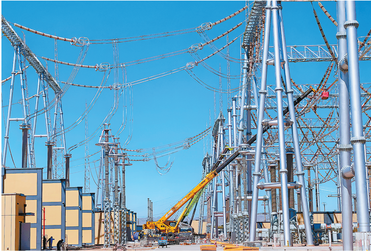
8月25日,在永昌县水源750千伏变电站建设现场,国网甘肃超高压公司员工开展电气设备验收等工作。
