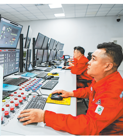
张掖液化天然气储备中心总控室内，工程师远程调度项目运行。
