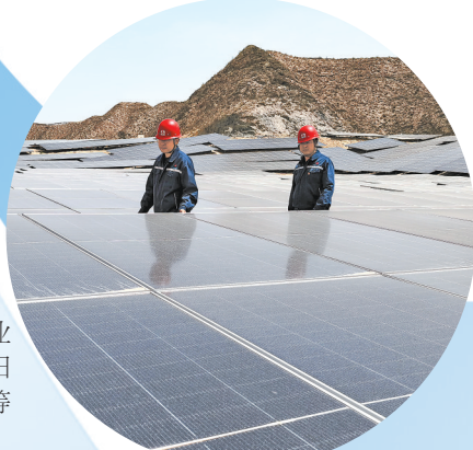
中十冶新能源白银有限公司工作人员在白银12.6兆瓦分布式光伏电站查看光伏设施。
