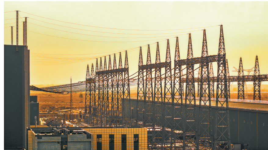
武威换流站换流变侧出线整齐排列蔚为壮观。
