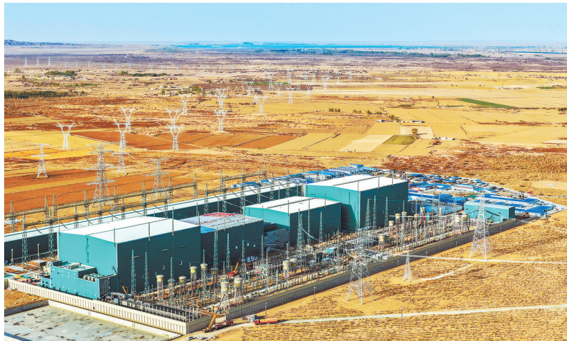
武威换流站航拍图。
