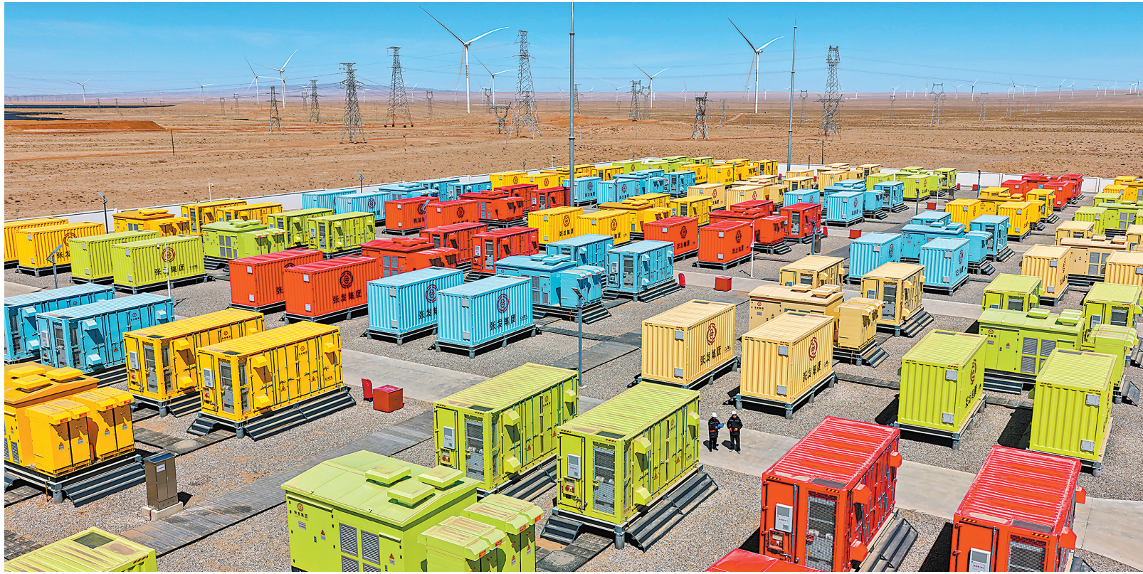
临泽县板桥镇羊台山下的300MW/1200MWh独立储能电站现场,色彩斑斓的储能集装箱排列有序,技术人员正在进行涉网大负荷试验及各发电单元间的联调工作。新甘肃·甘肃日报记者 田蹊
