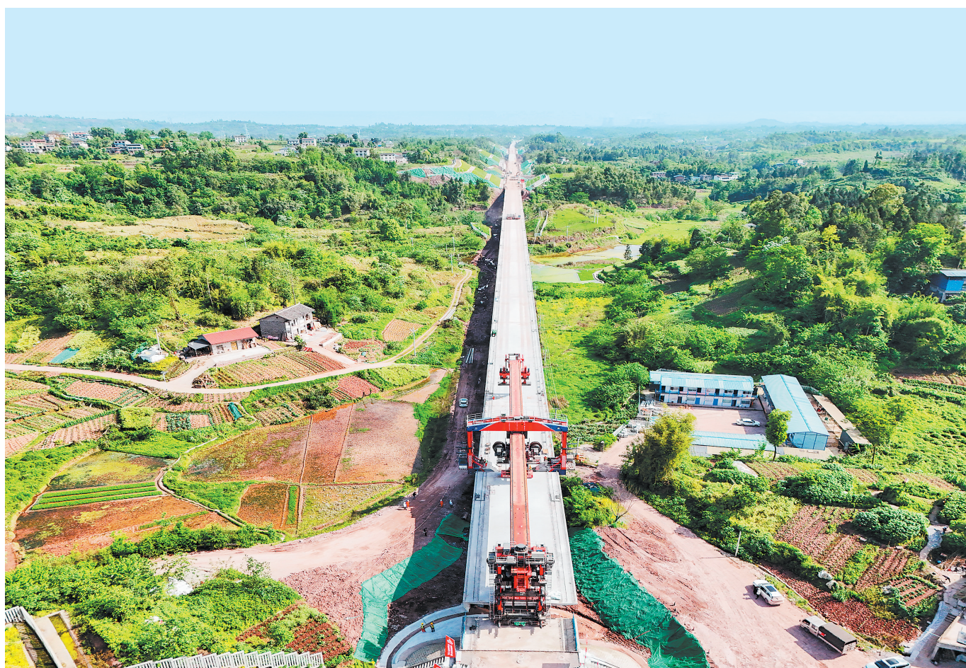
这是4月17日在四川省广安市境内拍摄的西渝高铁双拥特大桥架梁作业现场。当日,随着大桥最后一孔箱梁完成架设,标志着全长约115公里的西安到重庆高速铁路达州至广安段共1520孔箱梁架设完工,为下一步无砟轨道施工和铺轨创造了条件。 新华社发
