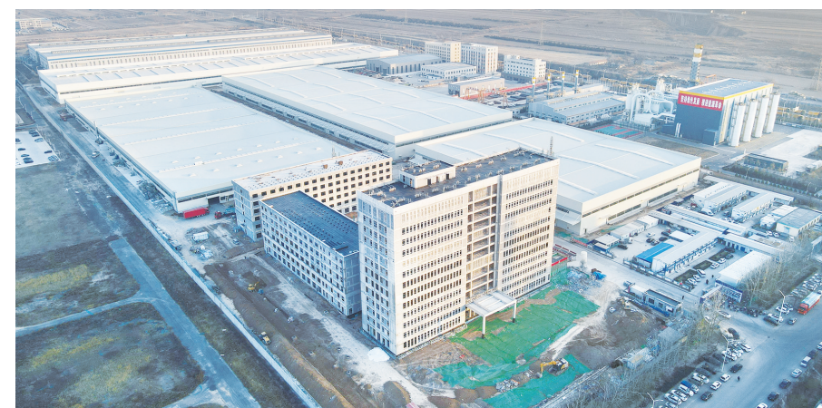
近日,由中铁十八局集团北京公司承建的山西新能源制造产业园项目施工现场机械轰鸣,施工人员各司其职、高效协作,各项建设任务稳步推进。截至目前,该项目办公楼、职工餐厅、宿舍楼二次结构均已完工并通过验收。
