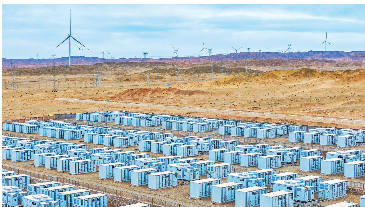
华景丝路300MW/1200MWh独立储能电站项目排列整齐的储电设备。
