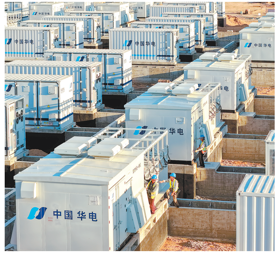
△甘肃华电武威民勤共享储能项目即将竣工。
