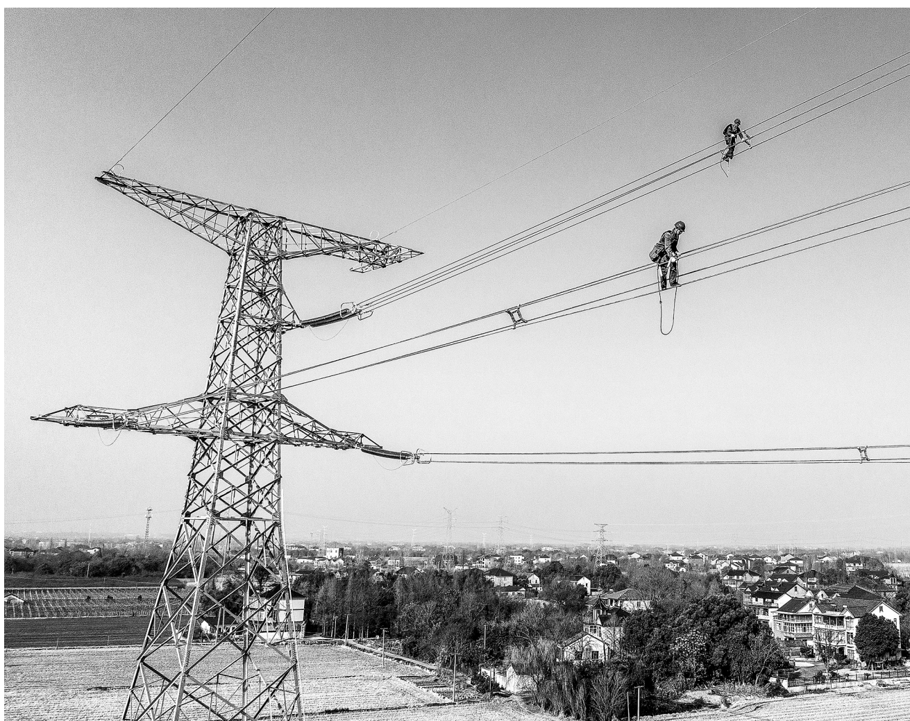
1月6日,国网湖州供电公司工作人员对500kV长兴输变电工程进行走线验收。位于浙江省湖州市的500kV长兴输变电工程预计年供电量可达70亿千瓦时,将于1月下旬正式投运。
