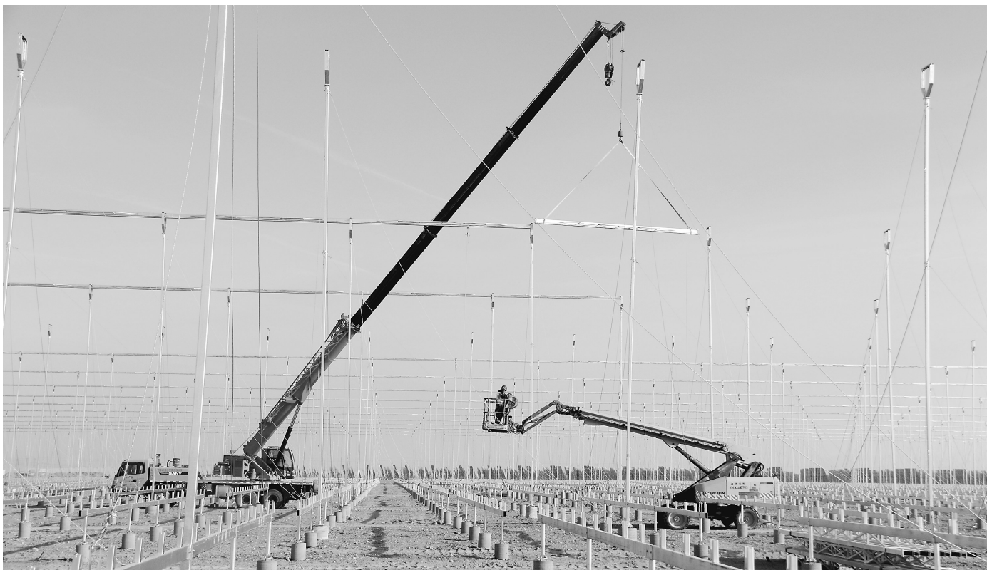
日前,敦煌光电产业园区内,工人在国家能源集团敦煌“光热+”项目建设现场施工作业。近年来,敦煌市抢抓国家新能源发展机遇,依托优越的风光资源,大力发展新能源产业,壮大绿色经济。
