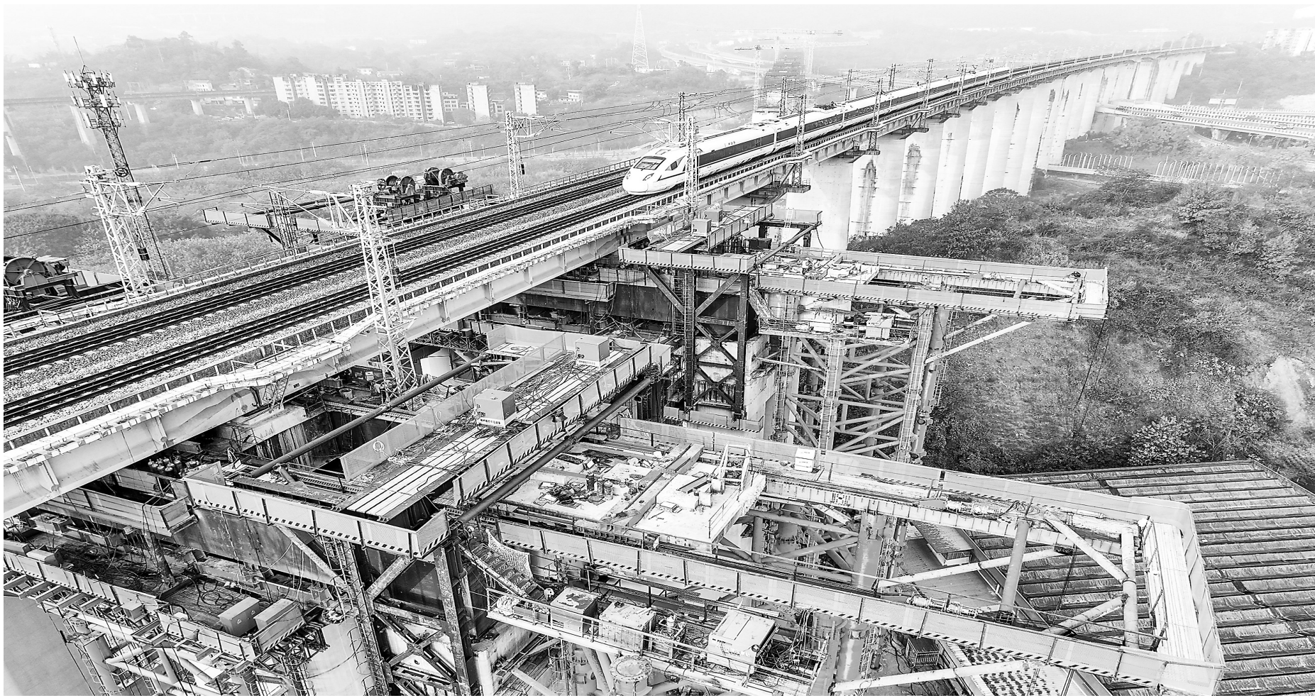
12月27日,在新建成渝中线下穿沪蓉线“托梁换柱”施工作业现场,一列高铁列车从沪蓉线新井口嘉陵江特大桥上驶过。当日,由中铁大桥承建的成渝中线井口双线特大桥下穿沪蓉线顺利完成“托梁换柱”施工作业,这在全国铁路建设领域尚属首例。
