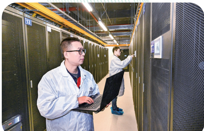
中国移动(甘肃·庆阳)绿色智算中心,技术人员在IDC机房检查设备运行情况。
