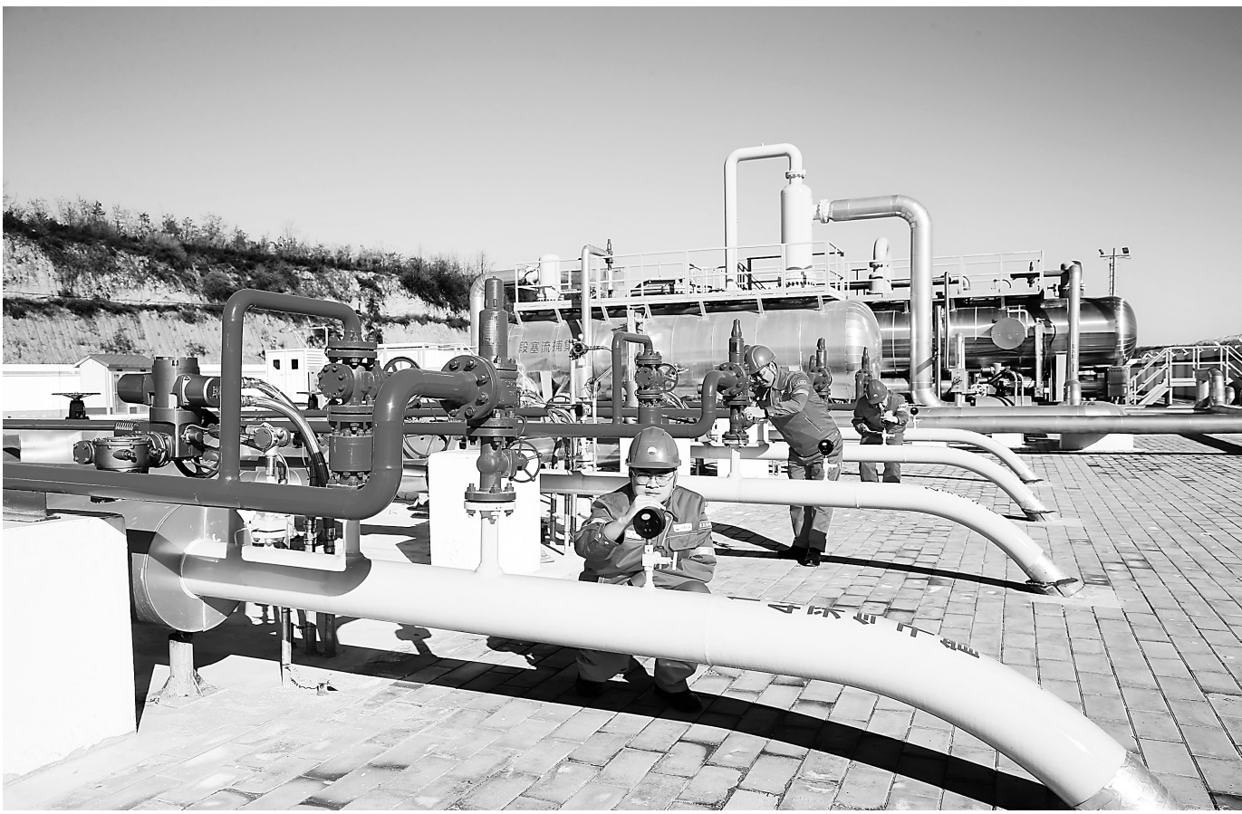
近日,宁县天然气输气主干线工程进入试运行阶段。宁县天然气输气主干线管道全长35.88公里,辐射十八个乡镇和两个工业园区,建成投运后将当地居民生产生活带来便利。 新甘肃·甘肃日报通讯员 李建琪
