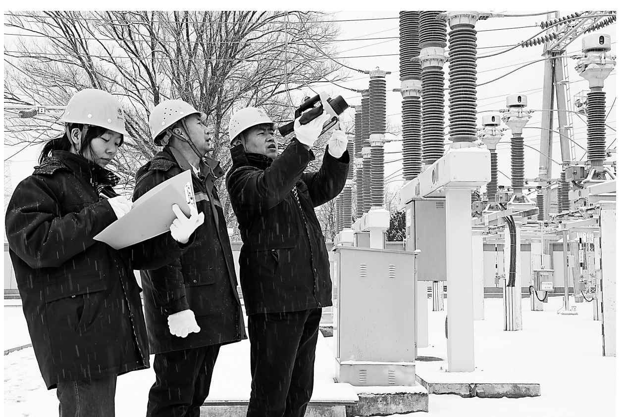
12月10日,国网平凉供电公司变电运维中心强化雨雪冰冻天气应对措施,加大专业巡视力度,提升应急处置能力,确保雪天群众生产和生活用电正常。
