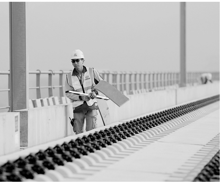
12月10日,中铁十二局的建设者在广湛高铁新兴建进行无砟轨道施工。广湛高铁正线全长约401千米,线路起于广州站,终至湛江北站,是国家“八纵八横”高速铁路网、时速350公里沿海铁路客运大通道的重要组成部分,目前已进入建设冲刺阶段。新华社发
