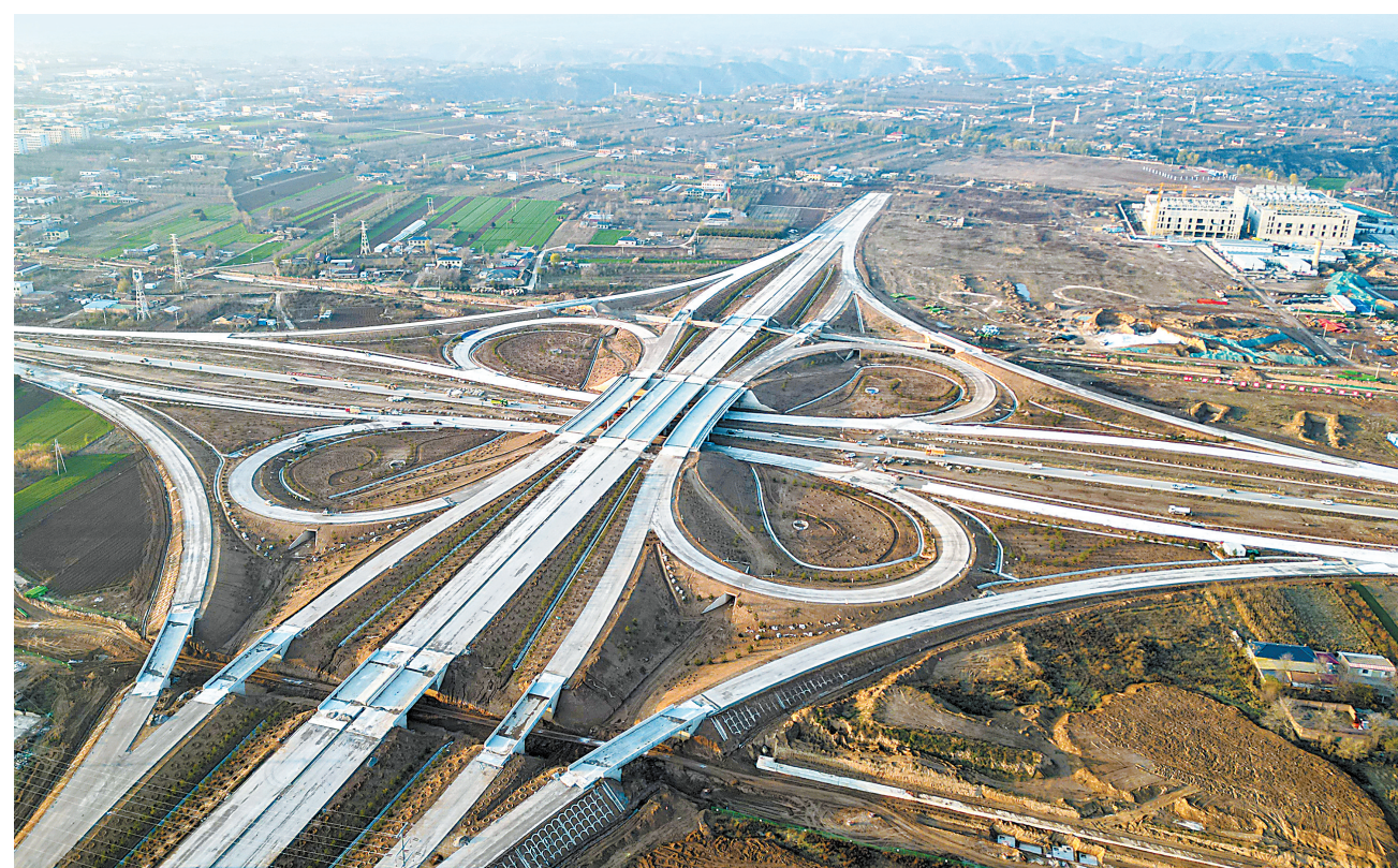
近日,G309线合水(老城)至西峰段工程西峰东枢纽立交项目加紧建设。
