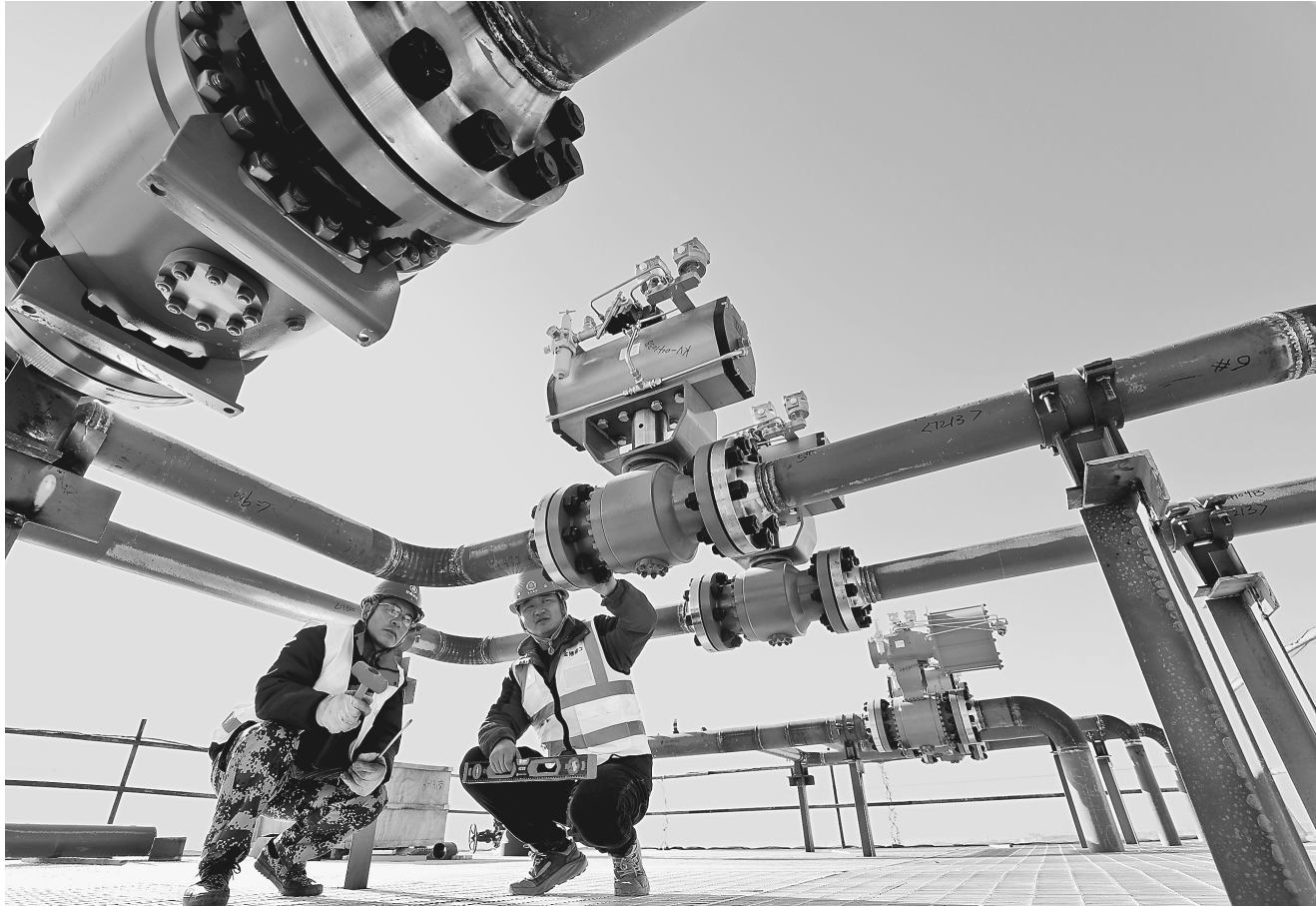
连日来,位于山丹县东乐滩的张掖LNG储备中心二期项目建设现场,建设者加紧施工,确保项目如期完工。据悉,该项目一、二期工程建成投运后,日处理天然气能力将达到150万立方米,成为我省最大的天然气应急储备基地。
