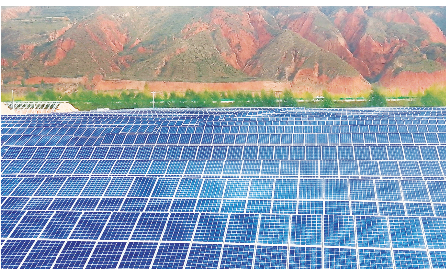
渭源县着力推进新能源建设。
