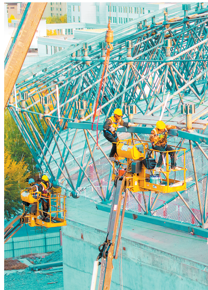
11月11日,张掖奥体中心建设项目工地,工人正在进行钢网架构件安装、焊接作业。 新甘肃·甘肃日报通讯员 杨潇
