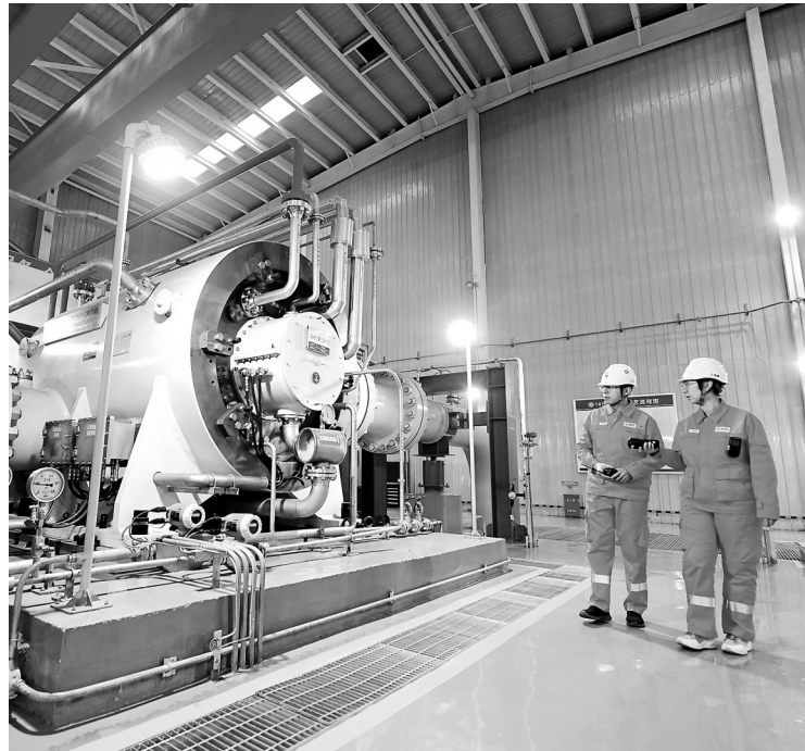
11月12日,廊坊(河北)永清联络压气站的工作人员在厂区内巡检。作为中俄东线天然气管道和陕京天然气管道互联互通的枢纽站——永清联络压气站,担负着京津冀地区供应天然气的重要任务。 新华社发
