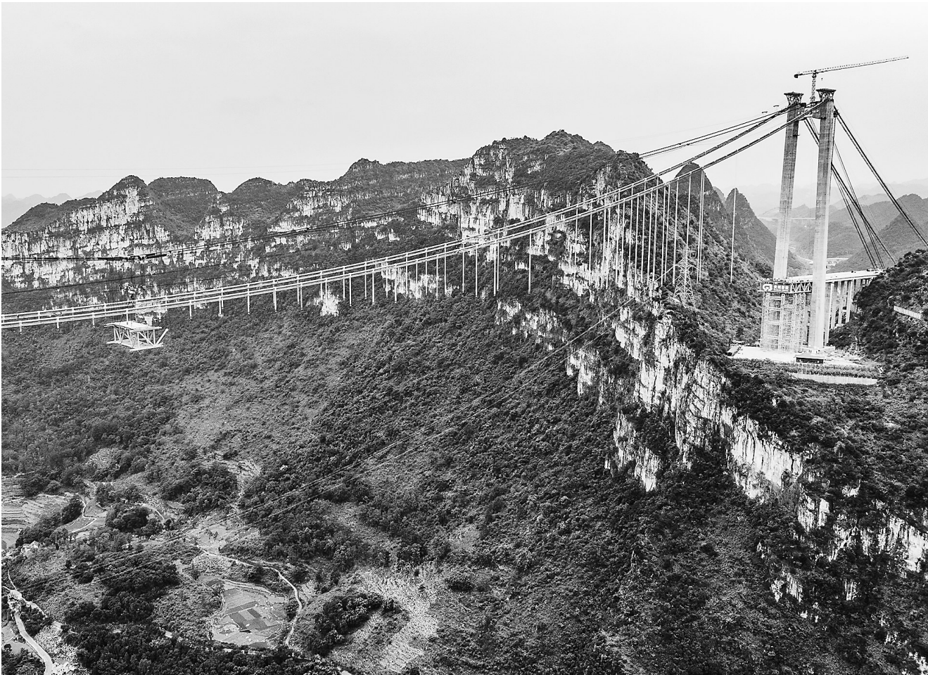
11月4日，贵州花江峡谷大桥的首件钢桁梁在吊装运输中。全长2890米的大桥为钢桁梁悬索桥，桥面距水面垂直高度625米，建成后将成为新的世界第一高桥。
