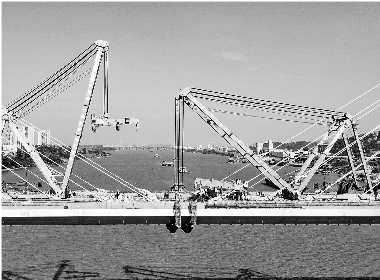
10月31日,广湛高铁佛山东特大桥跨东平水道斜拉桥最后一节钢梁吊装完成。
