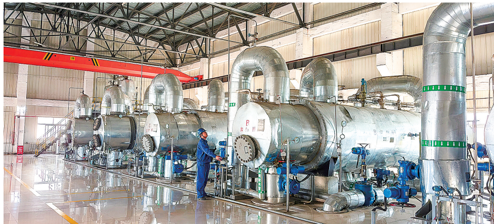
工作人员在检查供热设备。
