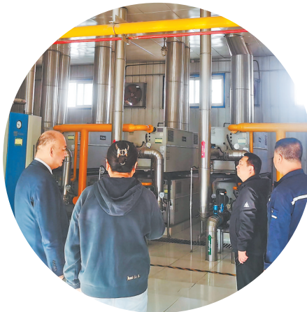
东岗西路街道工作人员走访供热站。东岗西路街道供图
