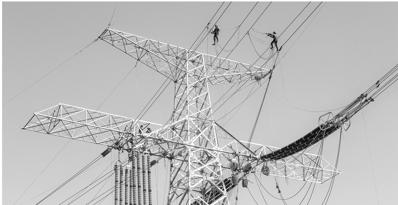
10月27日,位于张掖市甘州区境内的“西电东送”800千伏甘肃特高压直流工程输电铁塔(4标段)建设现场,电力工人在加紧施工。
