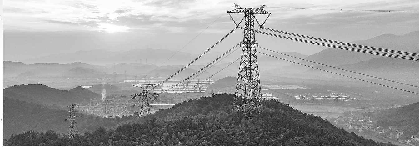
这是浙江省诸暨市次坞镇境内的宁夏灵州至浙江绍兴±800千伏特高压直流输电工程的输电线路(10月24日摄)。 新华社发
