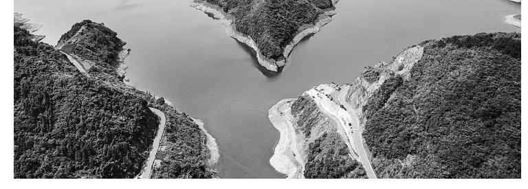
10月19日,湖北省十堰市中心城区水资源配置工程1标段2号隧洞精准贯通,标志着由中铁二十二局承建的1标段全线贯通,为该工程全面建成通水奠定了坚实基础。该工程建成后,不仅可以解决十堰中心城区生产用水问题,还将通过置换现有水库水量补充生态用水,改善城区河流的生态环境条件。方源彬
