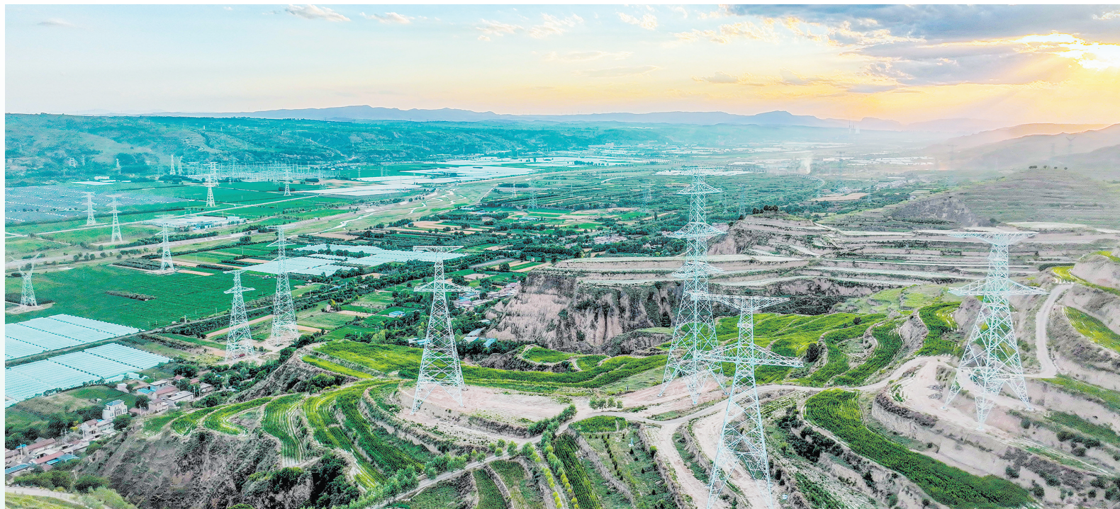
陇电入鲁工程项目正在加紧建设。 新甘肃·甘肃日报通讯员 黄蔚林
