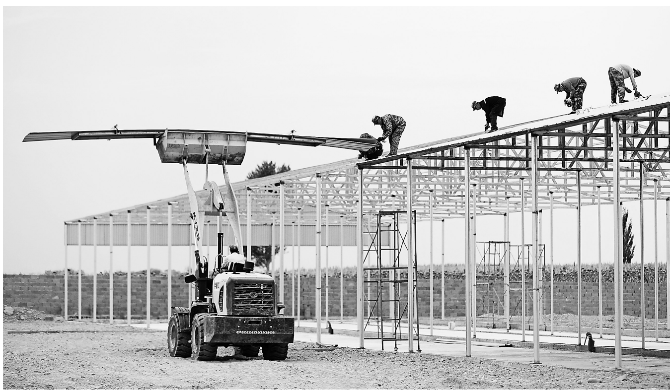
8月28日,民乐县民联镇下寨村万头肉牛标准化繁育基地项目建设现场,工人正在加盖顶棚。该项目占地面积320亩,计划总投资1.3亿元。
