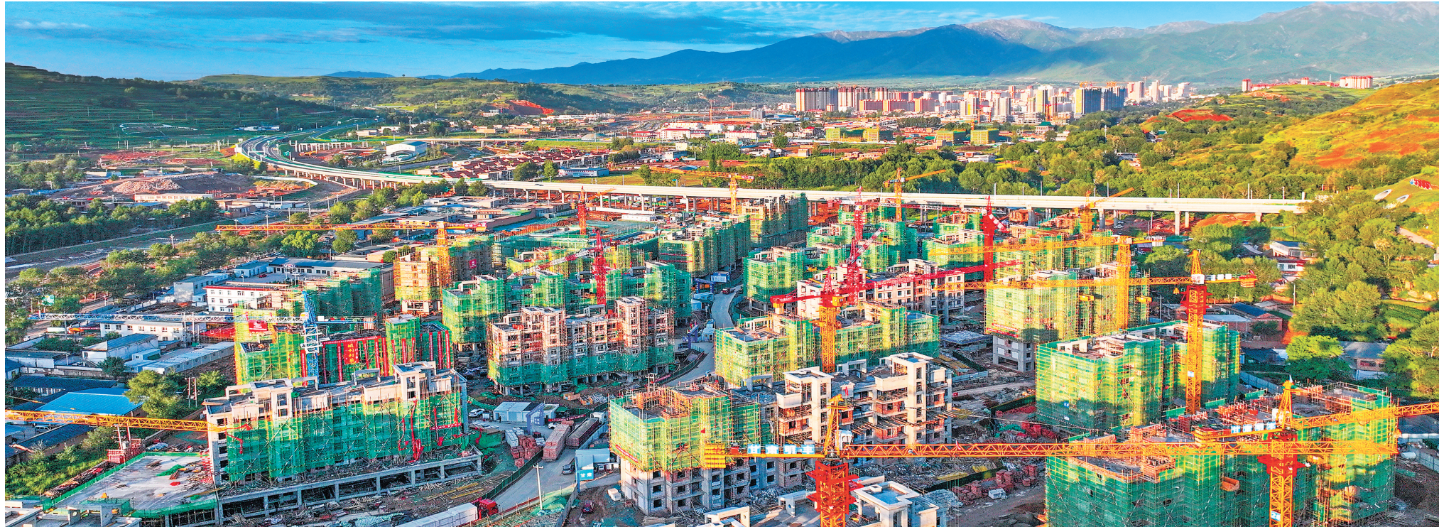
吹麻滩镇西片区集中安置点B、C区施工现场,一栋栋建筑鳞次栉比。
