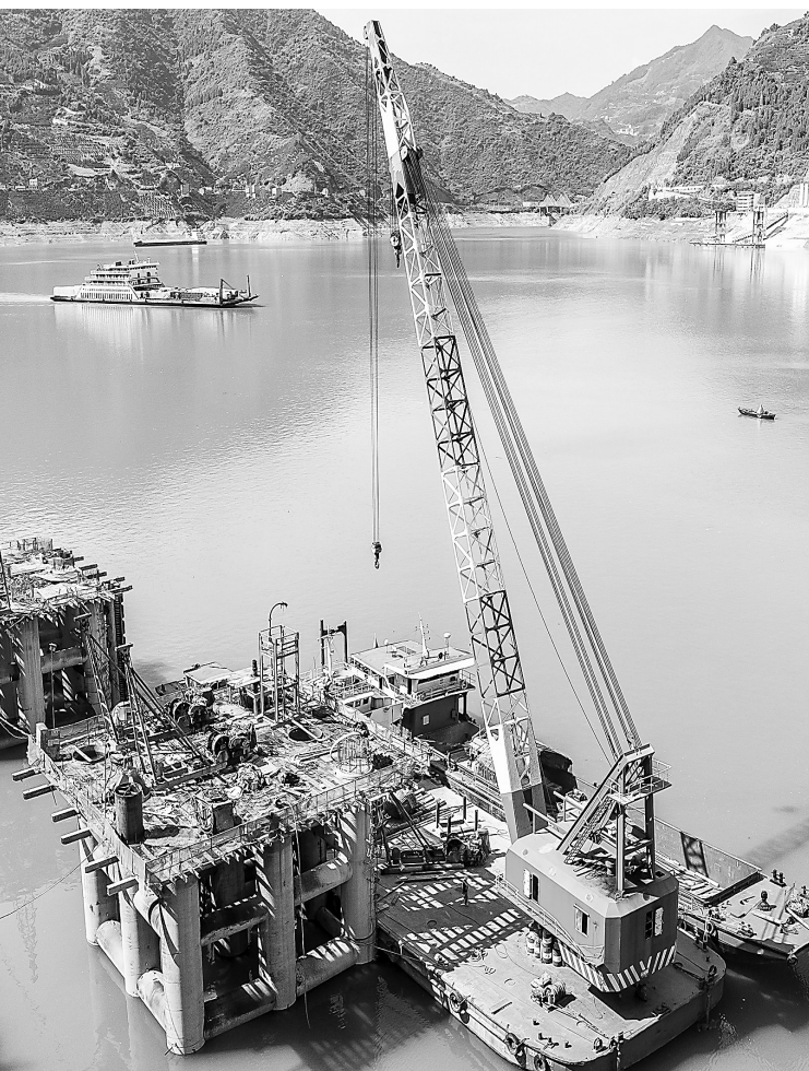
连日来,三峡通航船舶回归旧州河锚地建设者们抢抓三峡库区水位下降时机赶进度,建设工地一片忙碌。该工程建成后将有力缓解三峡船闸上游危化品锚地容量不足问题,提升通航服务水平。
