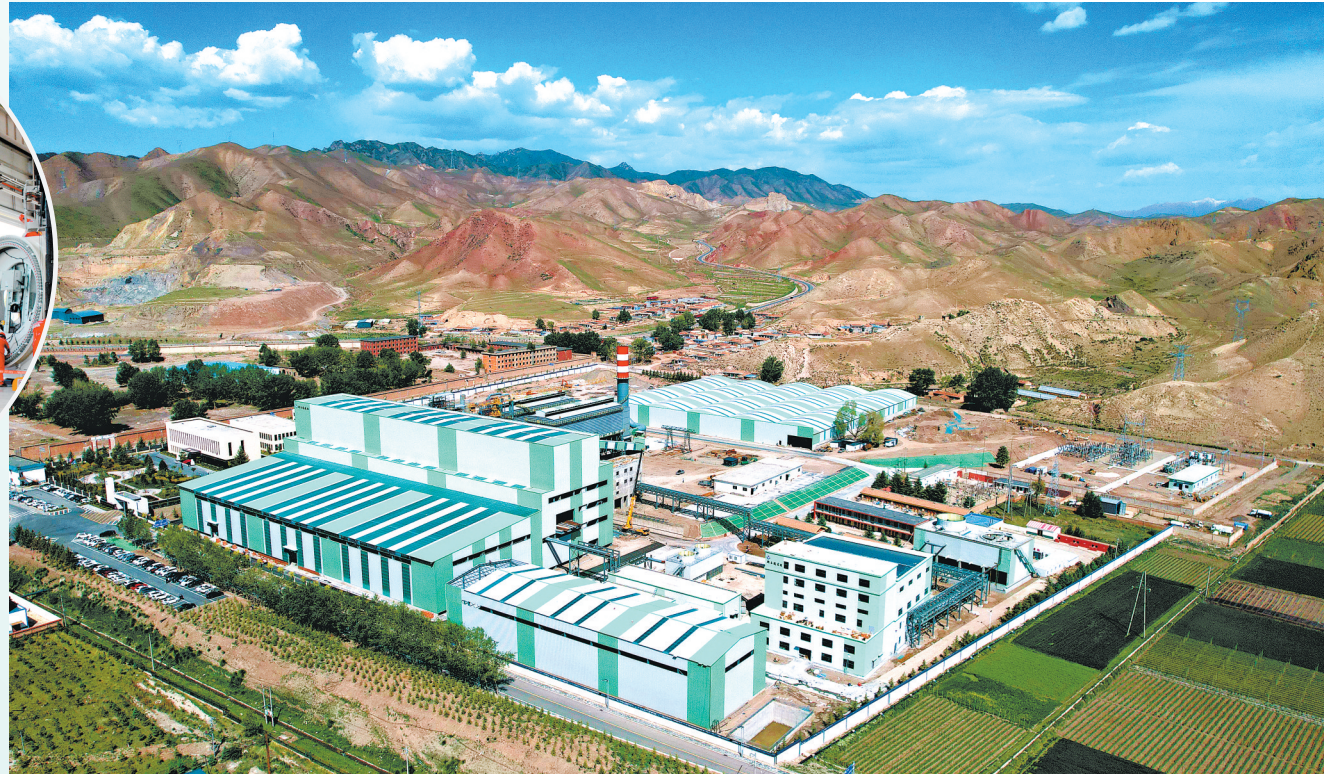
天祝县甘肃新玉通新材料年产6万吨工业硅项目建设现场。本组图片作者:新甘肃·甘肃日报记者 金奉乾
