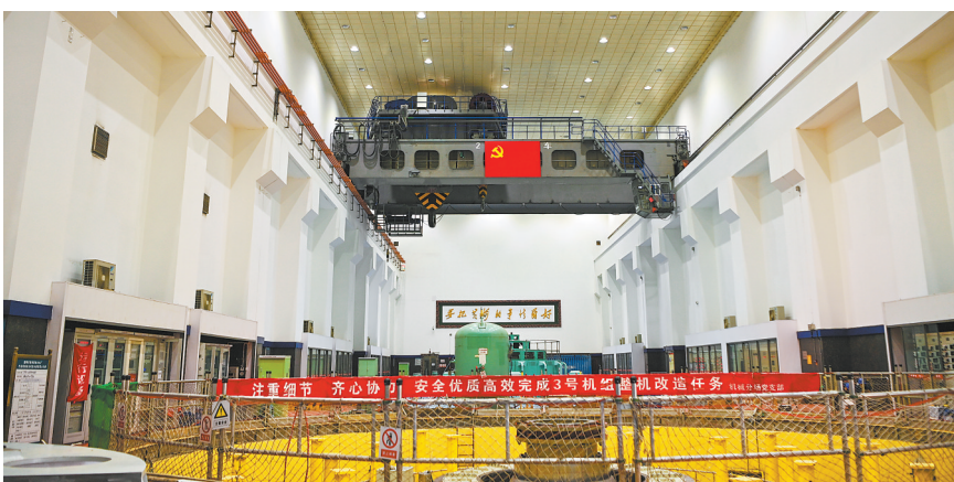
水电站厂房内景。
