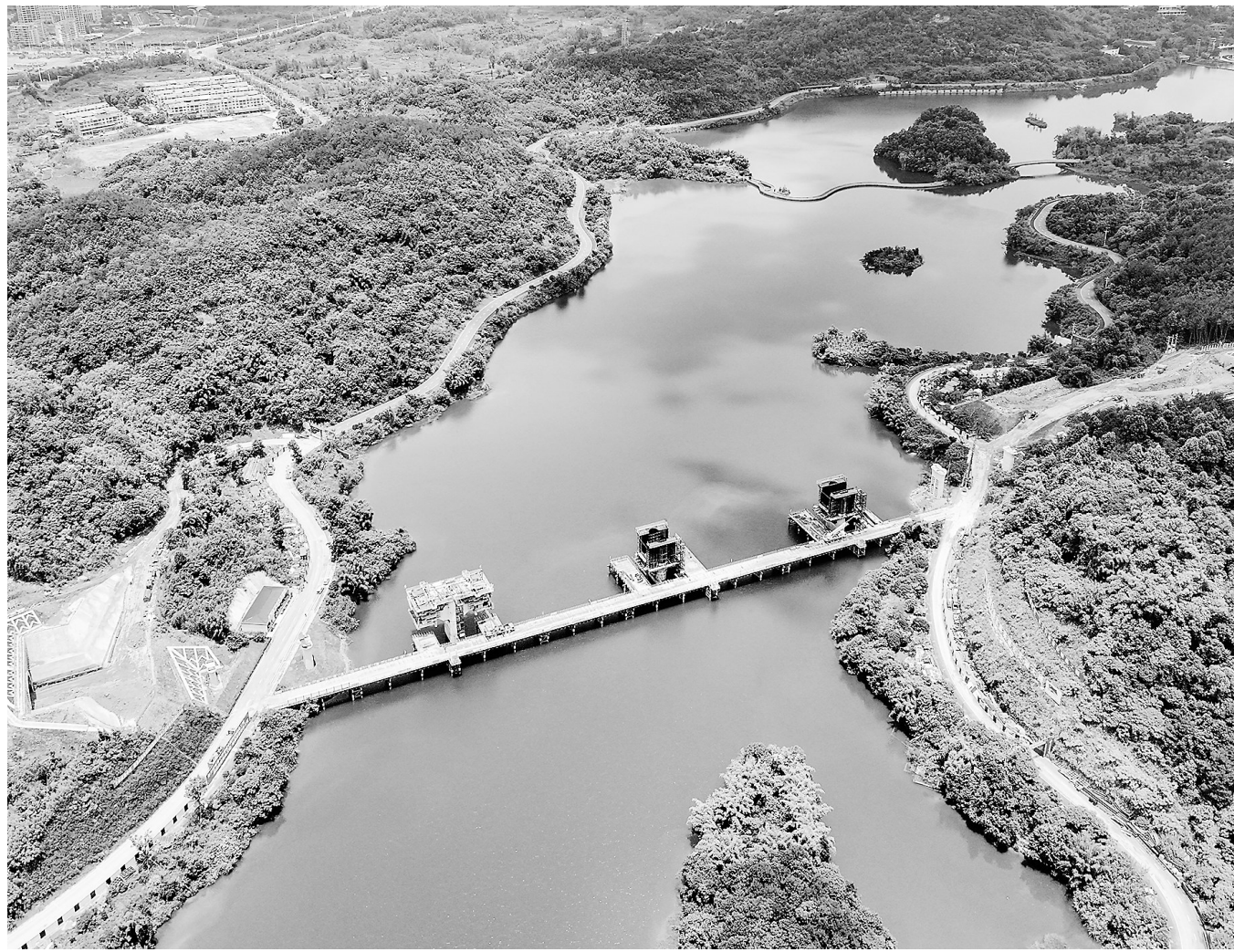
6月5日,成渝中线高铁天湖大桥建设现场。成渝中线高铁是我国“八纵八横”高铁网沿江通道的重要组成部分,正线全长292公里,设计时速350公里。新华社记者 唐奕
