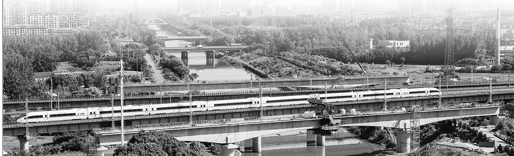
近日拍摄的新建沪宁合高铁引入合肥枢纽工程跨店埠河特大桥梁首段连续梁合龙现场。
