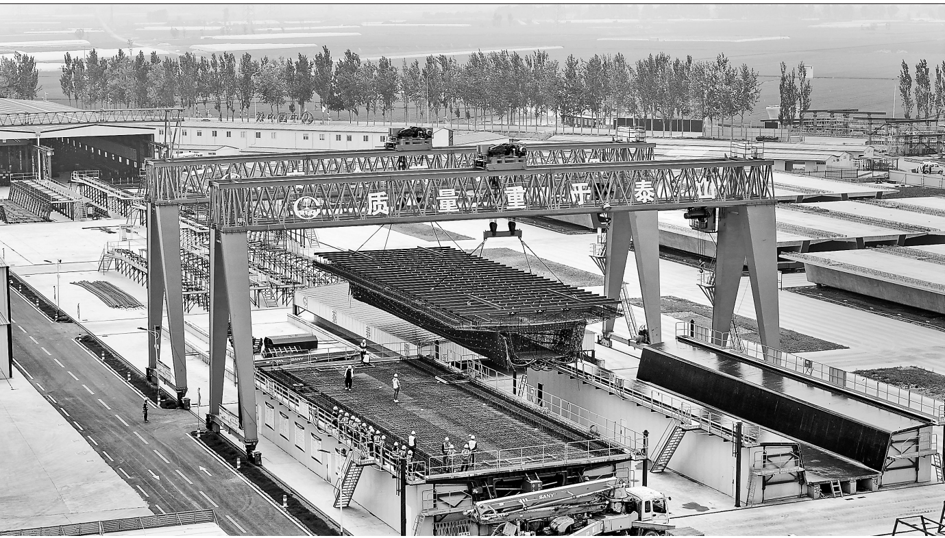
近日,国家重点工程(天津)津潍(坊)高铁潍坊段项目承建方抢抓工期,预制箱梁,为后续箱梁架设做好储备工作。图为4月29日,在津潍高铁中铁十局潍坊制梁场,工程机械在吊装箱梁钢筋骨架。
