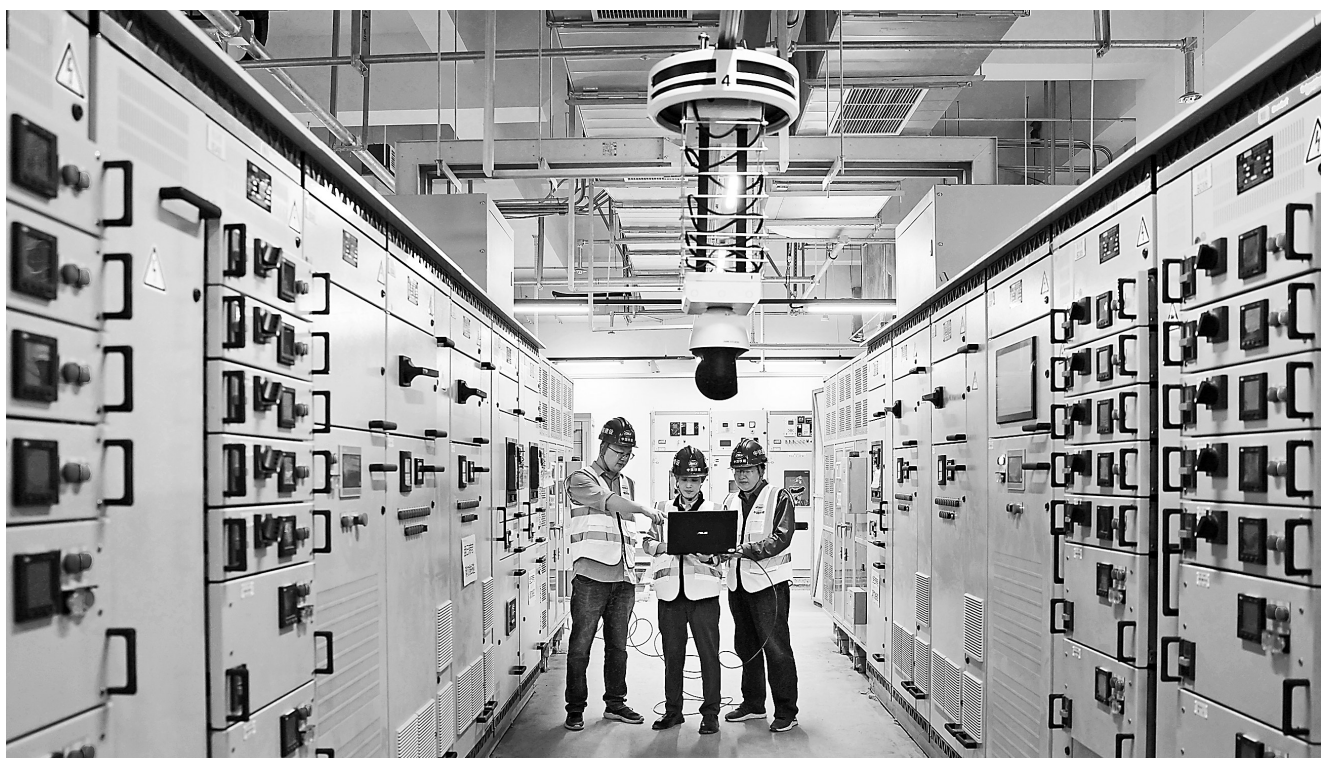
4月28日,在兰州中川国际机场T3航站楼配电站内,中铁建设集团技术人员正在调试设备。新甘肃·甘肃日报记者 田 蹊
