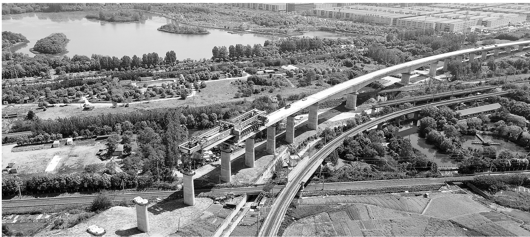
4月24日,合新铁路安徽段站前七标顺利完成上跨既有铁路淮南上行线架梁施工。图为施工现场。合新铁路起自安徽合肥,终至江苏新沂,设计时速350公里。新华社发
