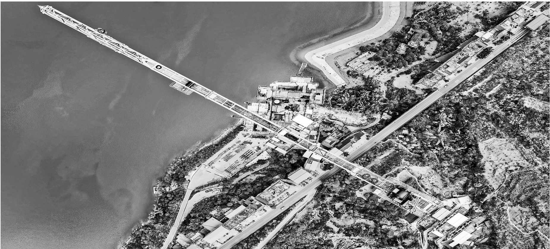
4月11日拍摄的新市金沙江特大桥施工现场。新市金沙江特大桥位于云南省沧源县南伞镇和四川省屏山县新市镇，是连接云南与四川两省的重要枢纽。
