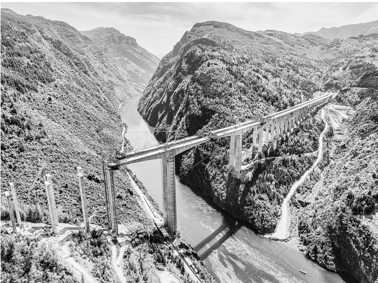
3月31日,位于重庆市武隆区境内的渝湘复线高速公路黄草乌江特大桥连续梁左幅中跨在进行合龙作业,目前该桥完成建设进度90%,桥面至江面最高通航水位高差180.941米。新华社发
