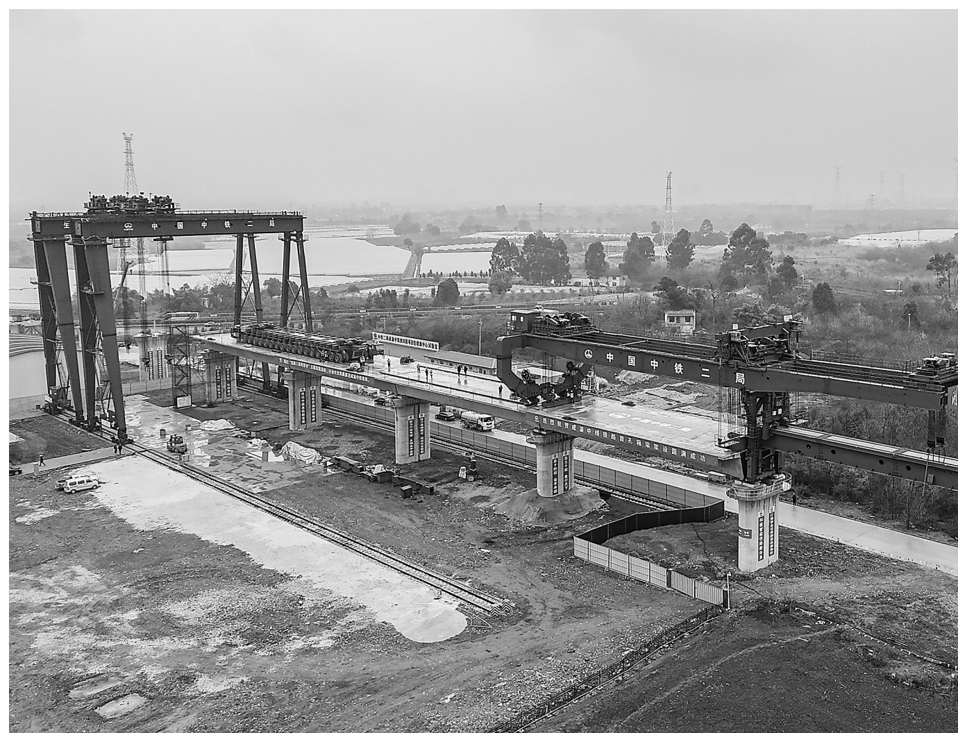
3月1日,在成渝中线高铁龙泉特大桥,中铁二局的工人正在进行架梁施工。当日,首孔长32米、重约700吨的箱梁在成渝中线高铁龙泉特大桥成功架设,标志着成渝中线高铁箱梁架设施工正式启动。
