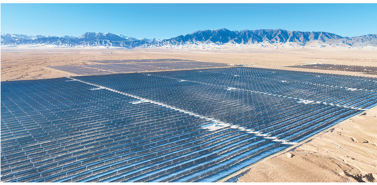
张掖市甘州区南滩30万千瓦光伏发电产业园光伏板排列有序,仿佛戈壁中的“蓝色海洋”。新甘肃·甘肃日报通讯员 冯杰
