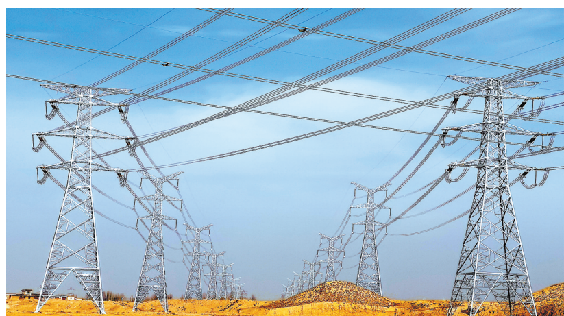
兰张三四线兰州段供电工程330千伏红乐变电站附近的供电网络。
